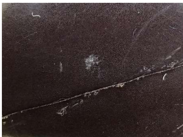
Mikro-repedésháló a lakk bevonaton
